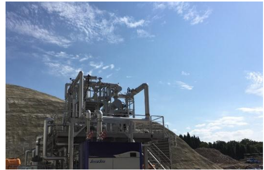
ジャパン・ニュー・エナジー水分発電所(大分県玖珠郡九重町)
